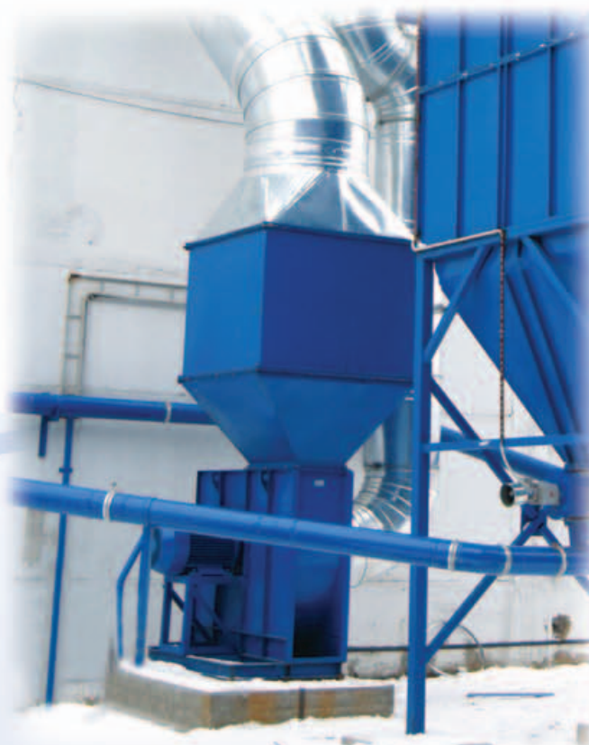
Вентилятор установлен после фильтра
