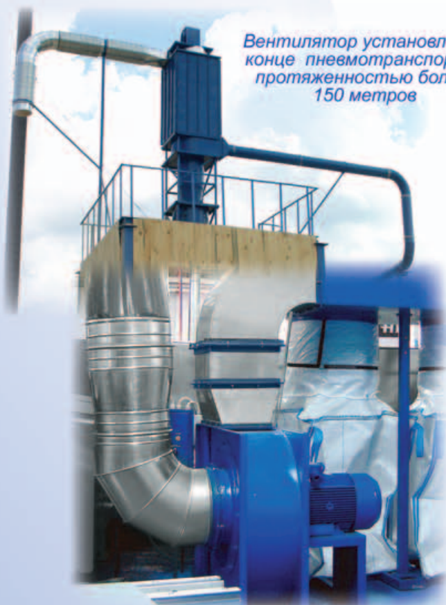
Вентилятор установлен перед Фильтроциклоном
